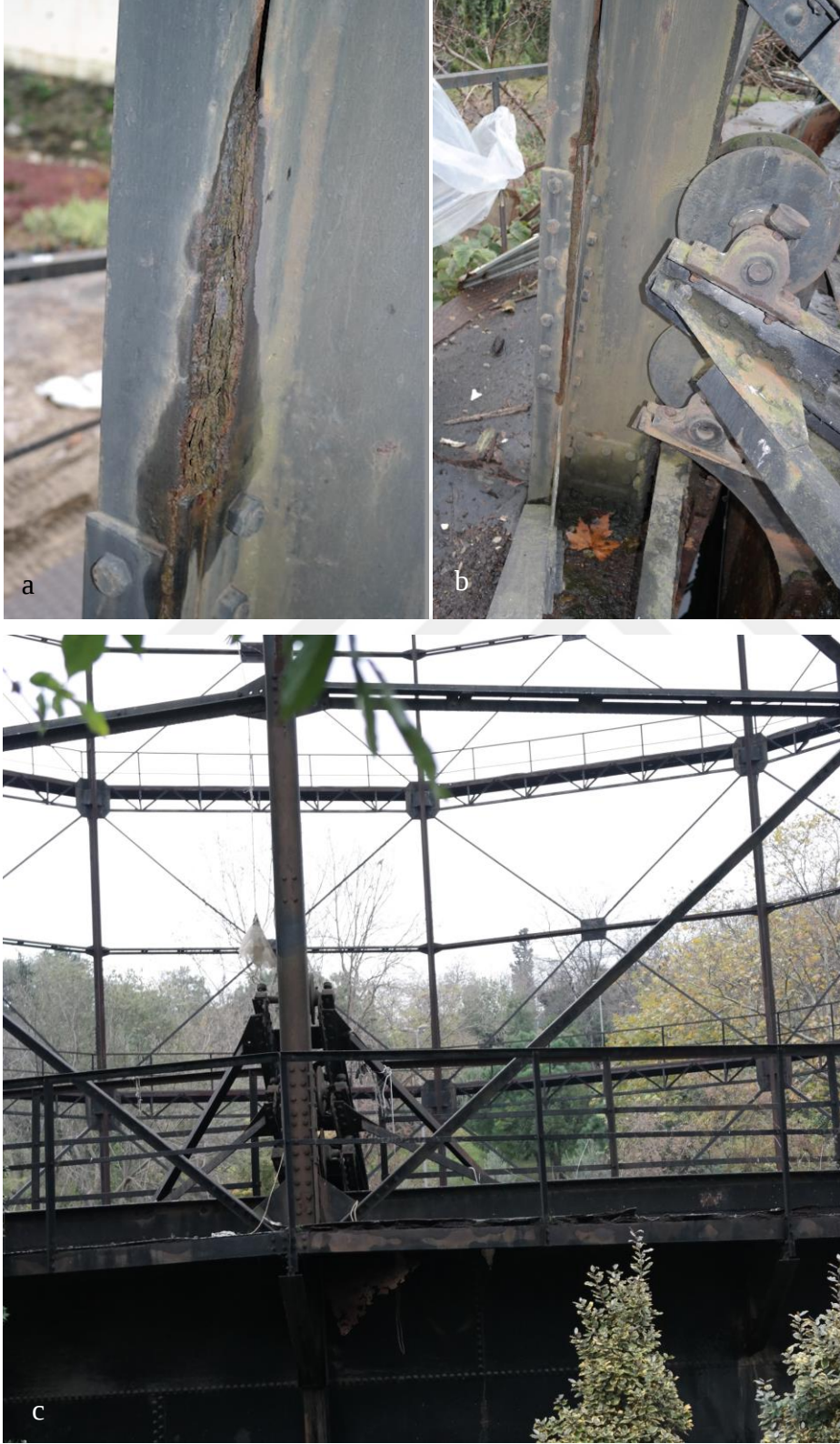
Şekil 4.12a, 4.12b, 4.12c: Yapıda oluşmuş korozyonlar.
