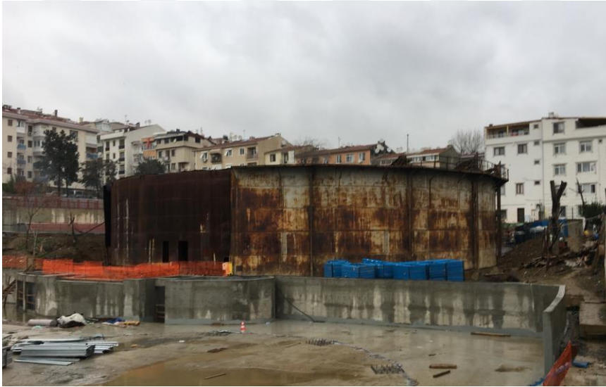
Şekil 3.38: Ga gazometresinin yıkılmadan kalabilmiş tank yapısı.
