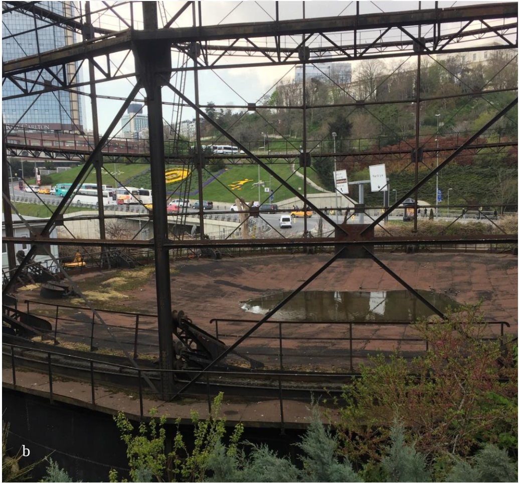
Şekil 4.13a, 4.13b: Yapıdaki deformasyonlar.
