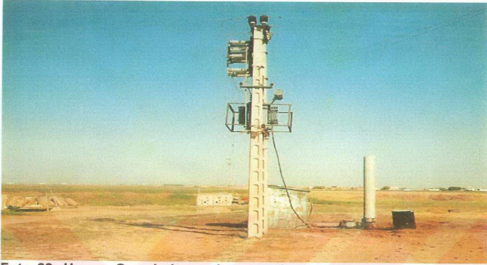
Foto 22: Harran Ovası'nda yeraltı suyundan yararlanılarak açılan bir sulama kuyusunun elektrik tesisatı ve dalgıç motorunun içinde yer aldığı kabin
