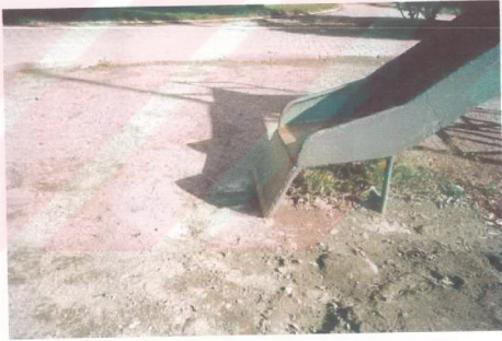
Şekil 4.9. Kaydırağın iniş bölümünde, zemindeki beton pabuçlar açığa çıkmıştır.
