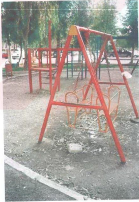
Şekil 4.12. Salıncağın zemininde ayak koyma yerleri mevcut değil.
