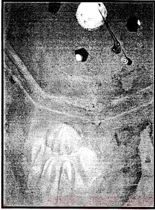
Resim 6. 12 Sarı Ahmet Paşa Hamamı Erkekler Kısmı Ilıklık Kubbesindeki Nemler
