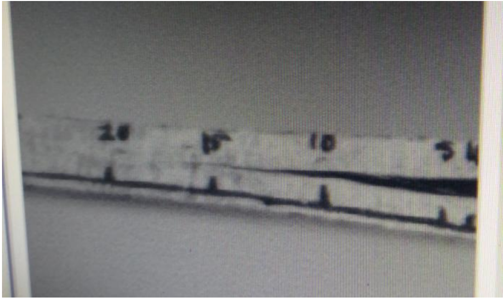
Şekil 16. Video kamera ile çatlak takibi esnasında alınan ekran görüntüsü.
