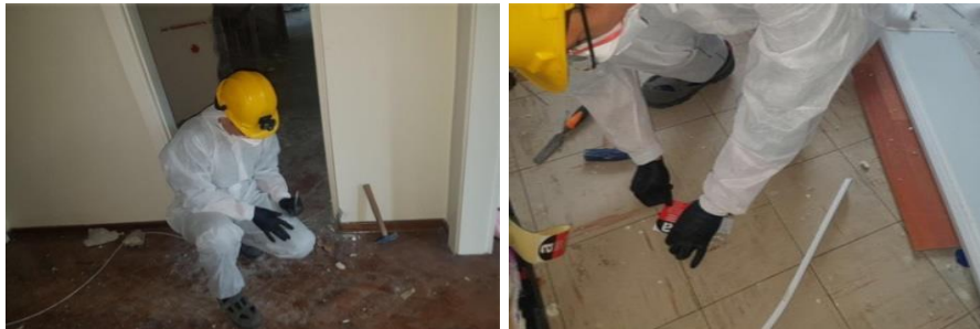
Şekil 4. 3 Asbestli olduğu düşünülen yapı ürünlerinden numune alımı [144]
