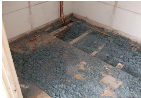
Şekil 4.3 Gevşek asbest yalıtım
