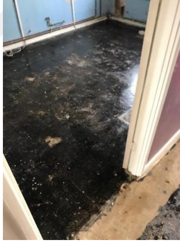
Şekil 4.9 Asbestli zift ve katranlar
