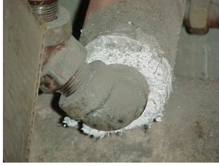
Şekil 4.4 Termal izolasyon yalıtım
