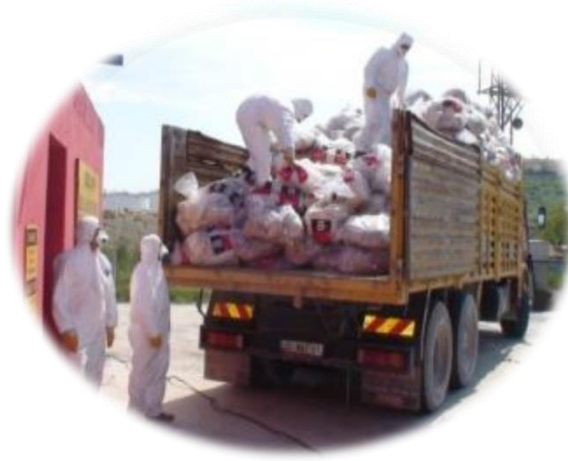
Şekil 6.12 Asbestli atıkların bertaraf tesisine gönderilmesi
