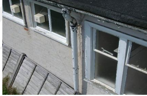
Şekil 4.12 Asbestli çimentodan mamul su oluğu
