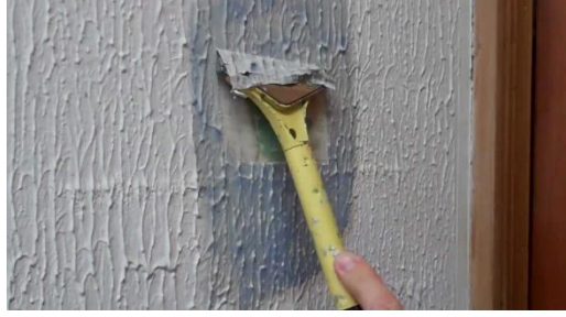
Şekil 4.8 Asbestli dekoratif boya ve sıvalar
