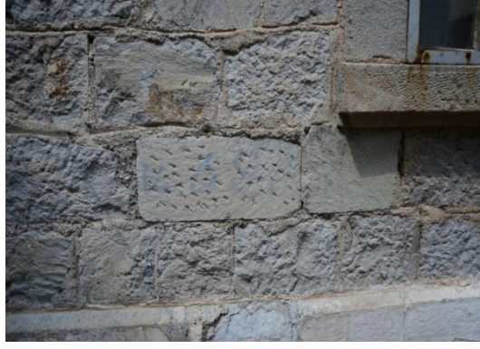
Fotoğraf 4.10 Redif Binası Cephesindeki Tarak İzleri,2012
