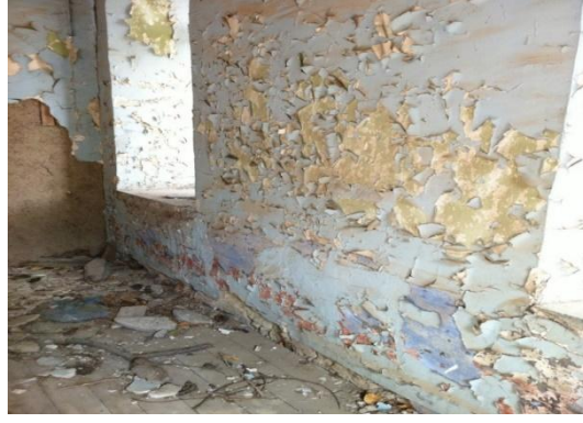
Fotoğraf 4.11 Redif Binası İç Duvarlarındaki Boya İzleri,2012
