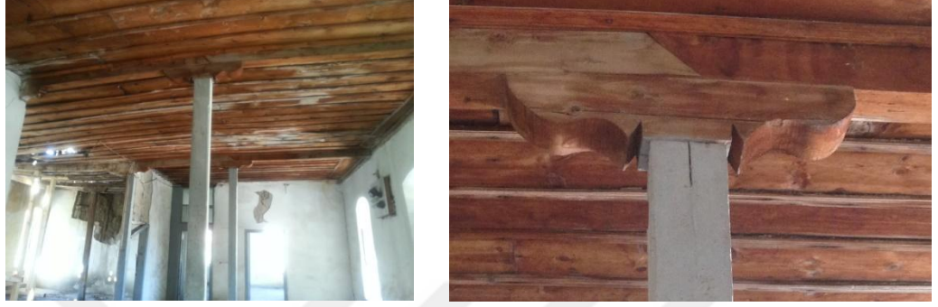
Fotoğraf 3.31 Redif Binası Birinci Kat Ahşap Kiriş ve Dikmesi, 2012
