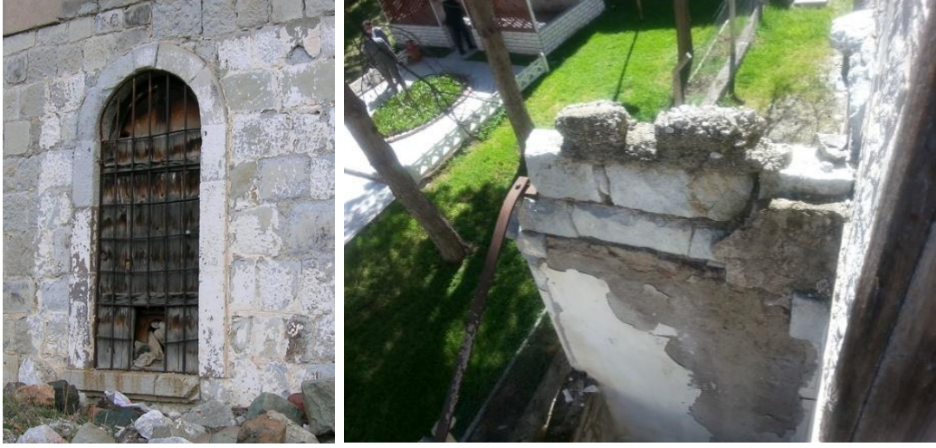
Foto 3.42 Redif Binasının Demir Elemanlarındaki Bozulmalar,2012
