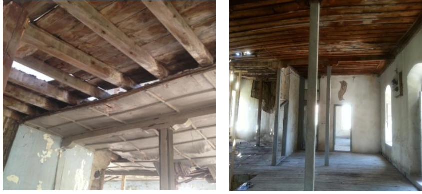
Fotoğraf 4.4 Kalecik Redif Binası Tavan Detayı,2012
