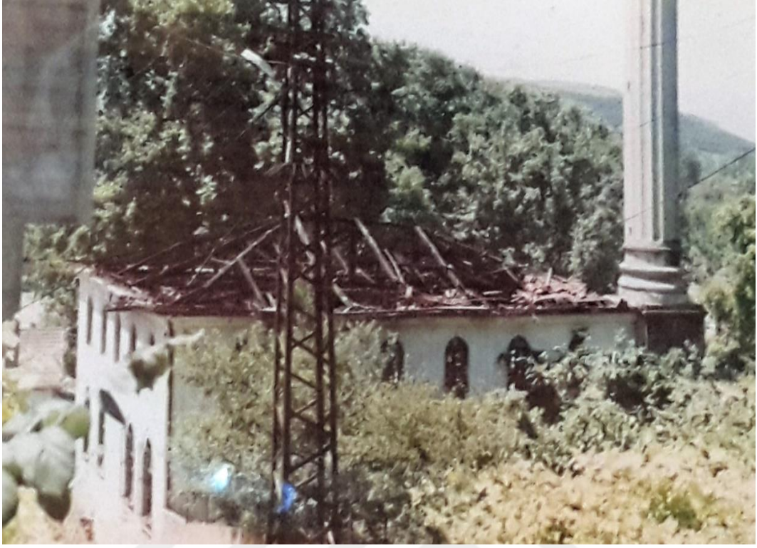
Foto 69: Kemer Köprü Camii - Yangın Sonrası Çatı ve Cepheler
