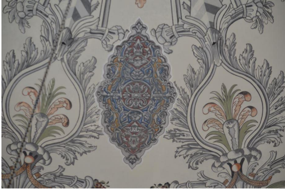
Fotoğraf 90: Nusretiye Cami Restorasyon Öncesinde Kubbede Yer Alan Şemse Motifi
