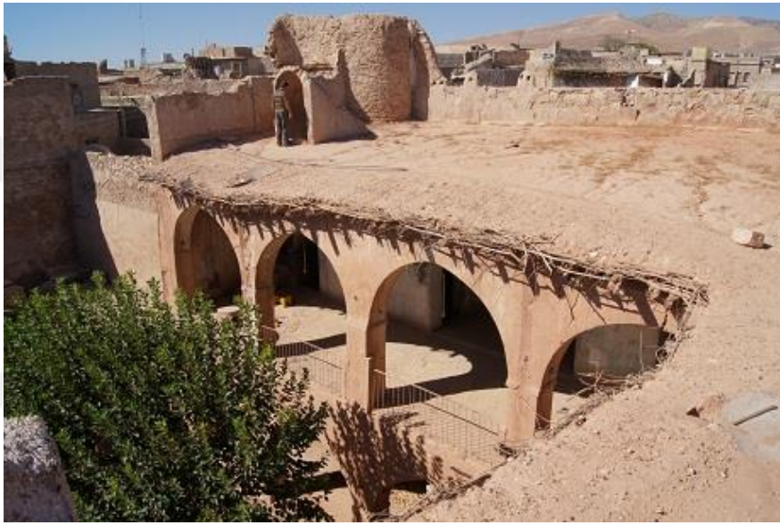
Şekil 3.55. K. H. Mecid evin damı restorasyondan önce
