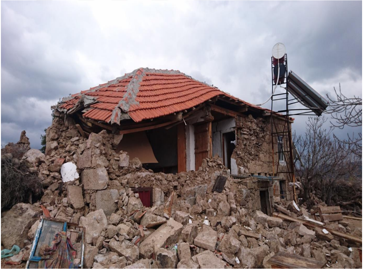
Şekil 1.27. Çamur ve taştan yapılmış yapıda köşeden yıkılma hasarı (İ.M.O.Ç.Ş., 2017, s. 4)
