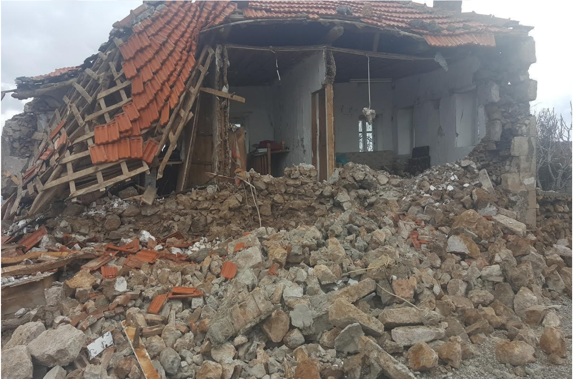
Şekil 1.34. Ağır hasarlı bir ev (Öztürk ve Koçak, 2017, s. 2)
