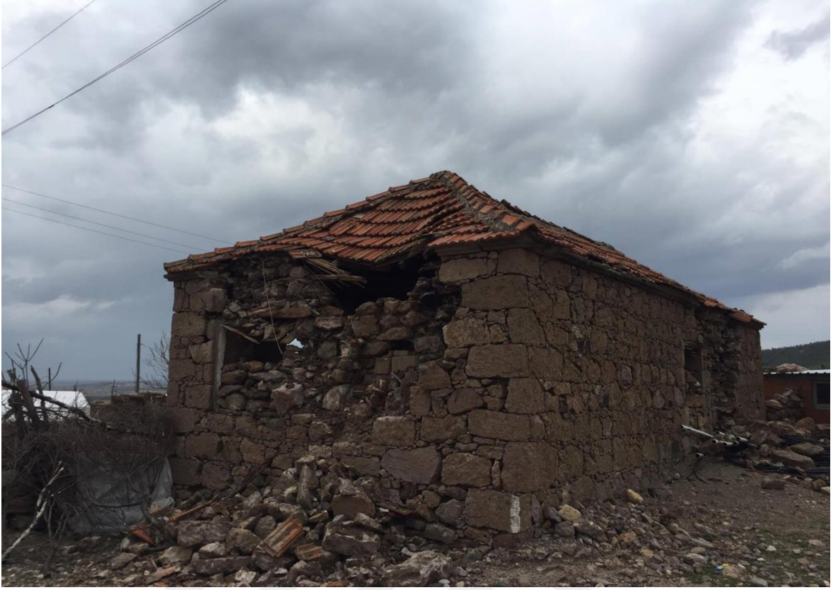
Şekil 1.33. Depremde zarar gören bir ev (Öztürk ve Koçak, 2017, s. 2)
