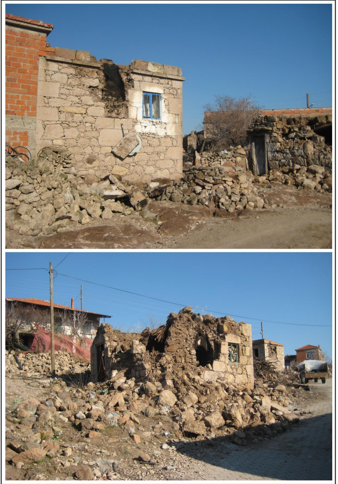
Şekil 1.32. Yukarık y’de bulunan yıĝma binalarda g zlenen hasarlar (Baba ve ark., 2017, s. 16)
