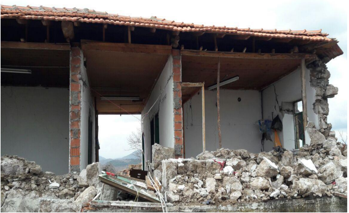
Şekil 1.28. Taş duvarlarda hasar bağlayıcı harç kullanılan duvarlar ayakta (İ.M.O.Ç.Ş., 2017, s. 4)
