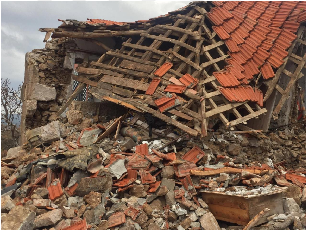
Şekil 1.31. Çamköy'de yıkılmış bir ev (Öztürk ve Koçak, 2017, s. 1)
