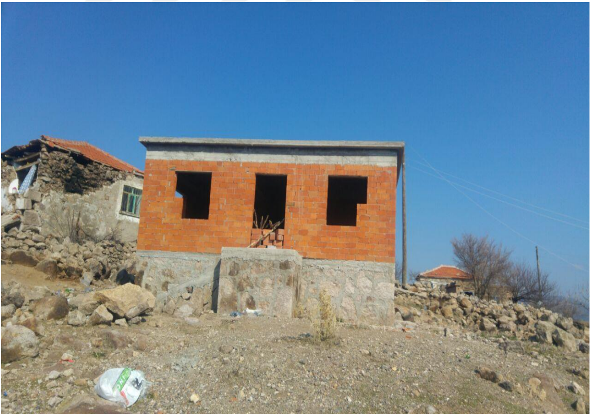
Şekil 1.29. Önde sağlam arkada ise ocak kullanımından dolayı hasar görmüş yapı (İ.M.O.Ç.Ş., 2017, s. 5)
