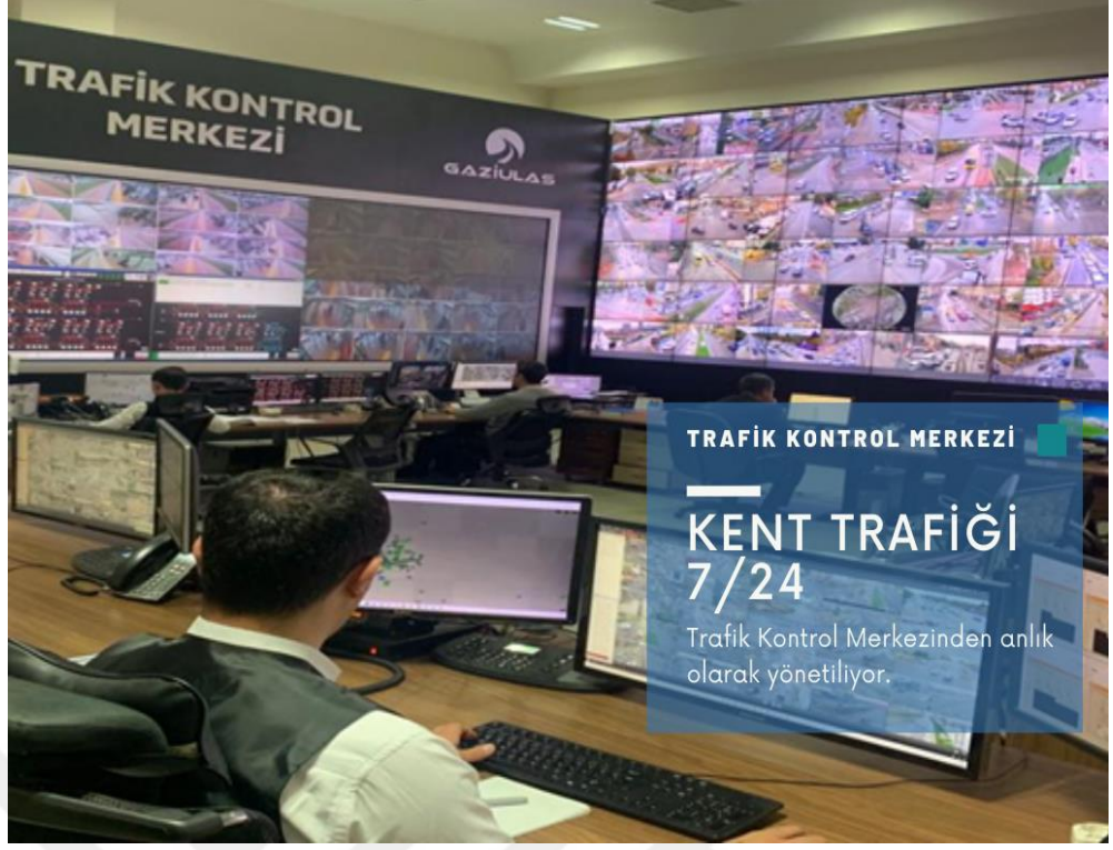
Şekil 4: Gaziantep Trafik Kontrol Merkezi
