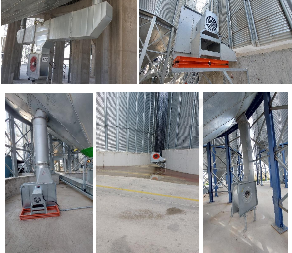
Şekil 4.25. Çelik silolarda kullanılan havalandırma sistemlerine ait görüntüler
