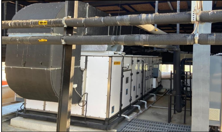
Şekil 3.12 Nephrocan firması HVAC
