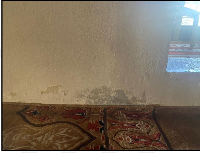
Şekil 50. Batı duvarda meydana gelen sıva dökülmesi
