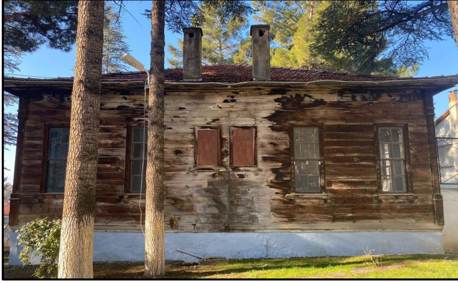
Şekil 168. Kuzey cephede meydana gelen bozulmalar; ahşap kaplamada renk değişimi ve aşınma, su oluğunun metal yüzeyinde eğilme
