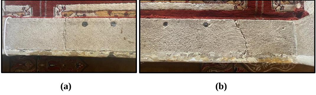
Şekil 49. a;b) Denizliklerde meydana gelen kılcal çatlaklar
