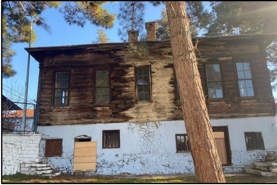
Şekil 169. Güney cephede meydana gelen bozulmalar; ahşap kaplamalarda renk değişimi ve aşınma, depo girişlerinin niteliksiz ek ile kapatılması, sıva dökülmesi, taşlarda aşınma ve malzeme kaybı
