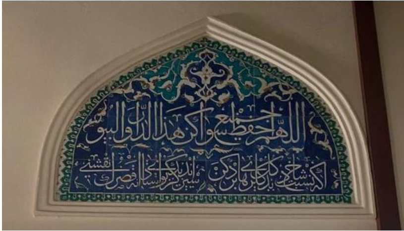
Şekil 25. Batı iç duvarında sağdan birinci pano (B1).
