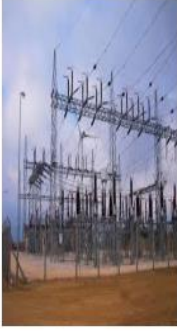
a. Elektrik santrali
