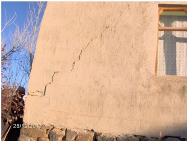
Şekil 3.2. Duvar ayrışması (2012 Van depremi) (Alicioğlu, 2012)
