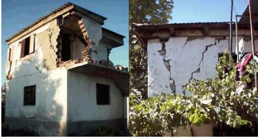
Şekil 3.1. Yığma yapılarda görülen farklı hasarlar (Çırak 2011)
