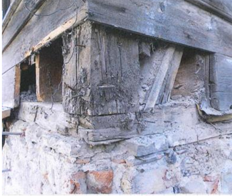
Görsel 85. Ziyaeddin Efendi Köşkü köşe detayı (Yapı Merkezi Arşivi, Fotoğraf: Fatih Yılmaz, 1992).
