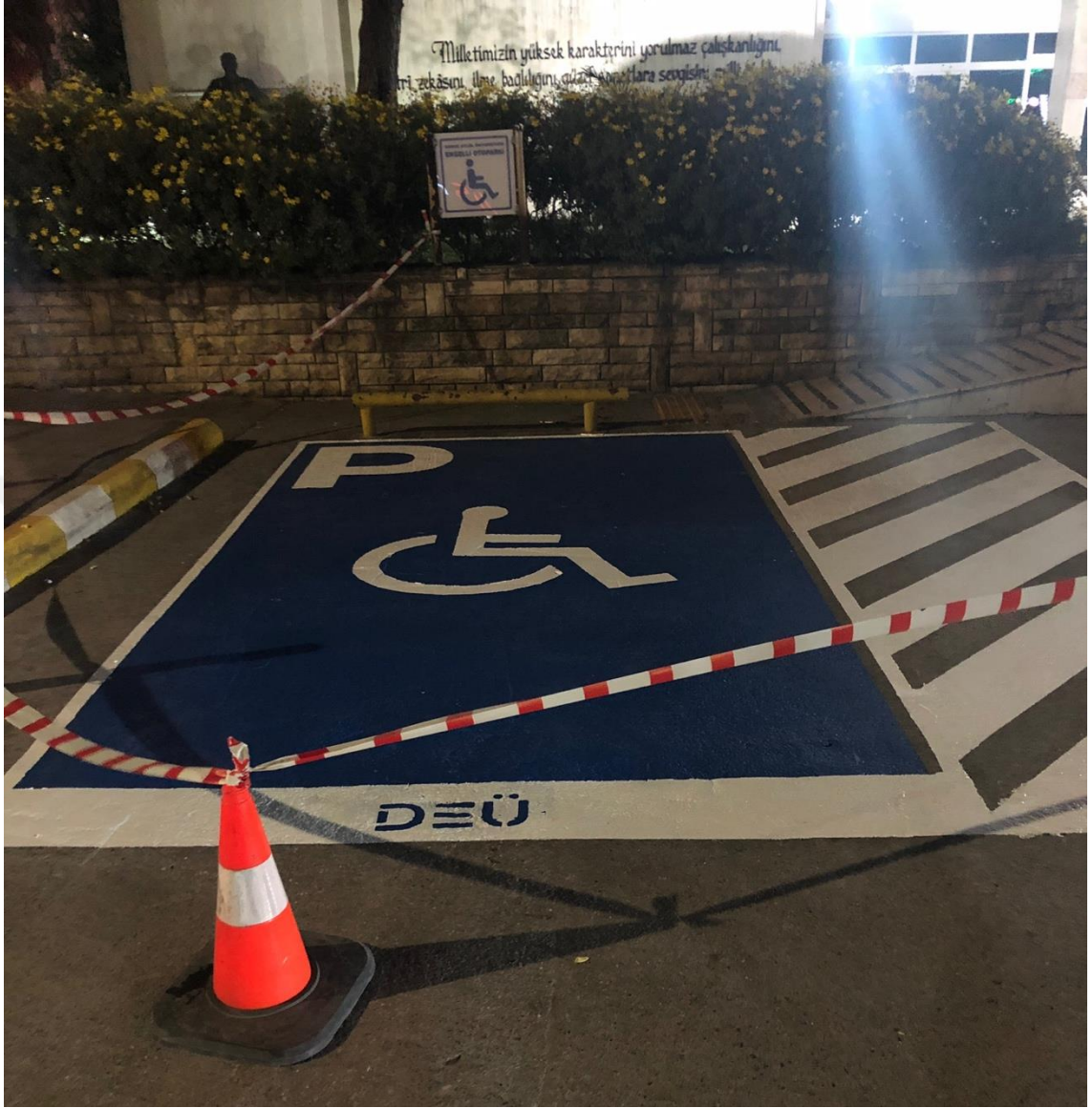
Resim 52 – Dokuz Eylül Üniversitesi Rektörlüğü Engelsiz Otoparkı Uygulaması
