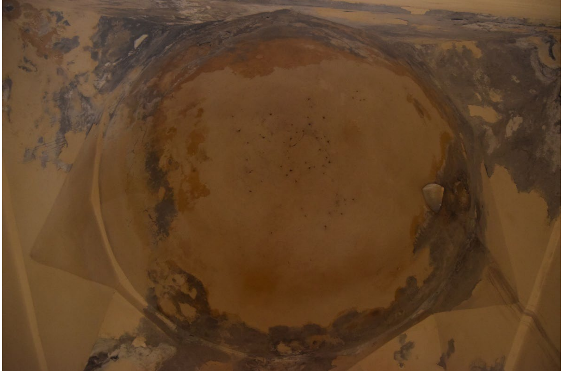
Foto. 5 Gökmedrese Cami 2020 Yılına Ait Restorasyon Öncesi Durumu (VGM Arşivi)
