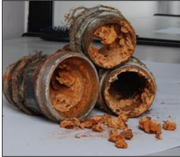
Şekil 2.1: Yüzey işlemsiz, korozyona maruz kalan metal örneği.
