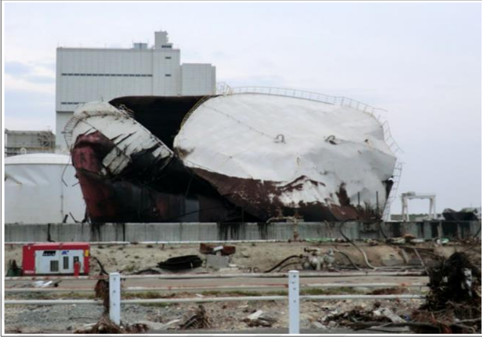
Şekil 2.17: Tohoku tsunami sebebiyle oluşan tank hasarı.
