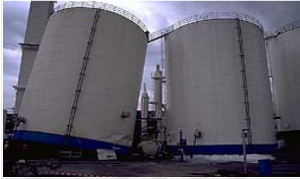
Şekil 2.12: Habaş tank duvarı hasarı (17 Ağustos, 1999).
