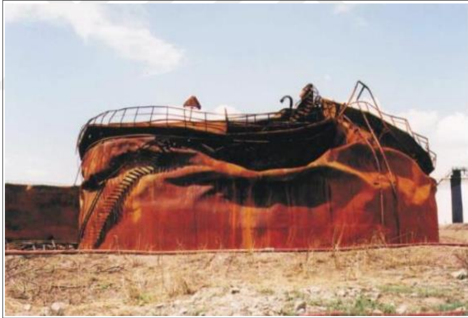
Şekil 2.6: Tüpraş rafinerisi hasar görmüş tanklar (17 Ağustos, 1999).
