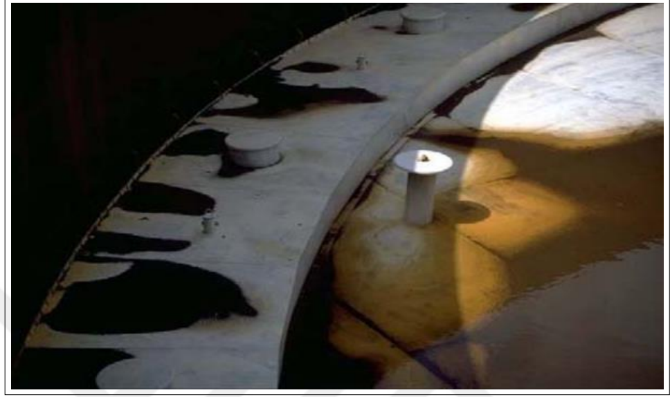
Şekil 2.9: Tüpraş rafinerisi tank duvarı hasarı (17 Ağustos, 1999).
