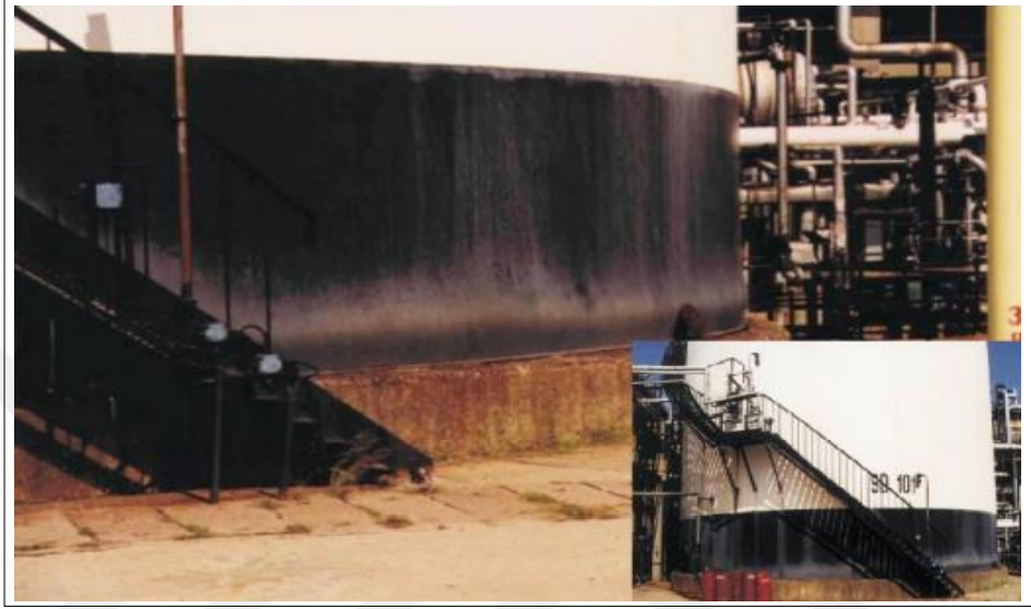
Şekil 2.7: Tüpraş rafinerisi tank fil ayağı oluşumu (17 Ağustos, 1999).
