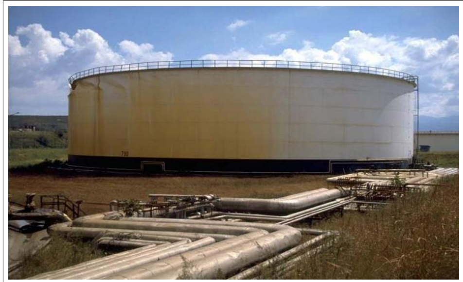
Şekil 2.8: Tüpraş rafinerisi tank duvarı hasarı (17 Ağustos, 1999).
