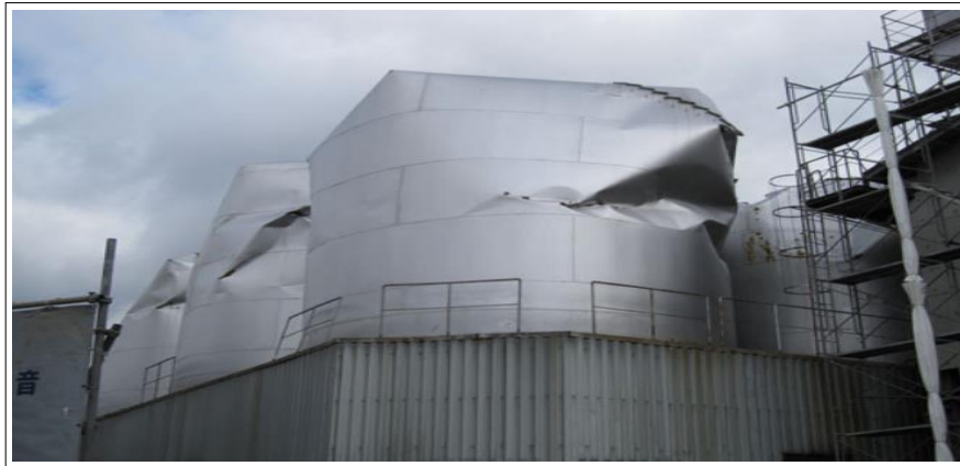
Şekil 2.18: Tohoku depremi sebebiyle oluşan silo burkulması hasarı.
