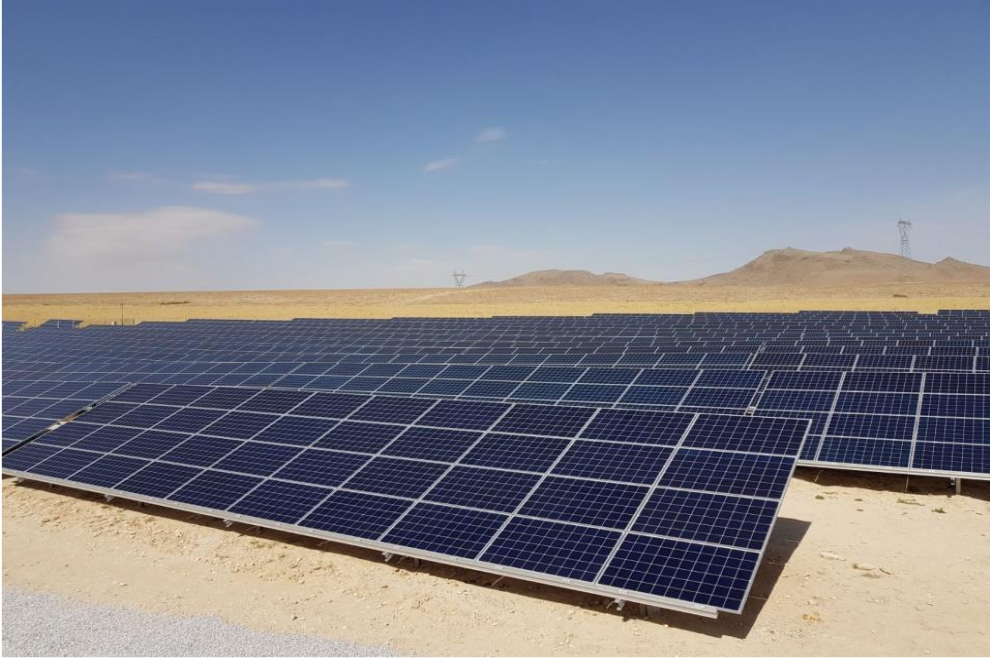
Şekil 3.6. Açık arazi tipi Fotovoltaik sistem örneği (Atlım, 2019)
