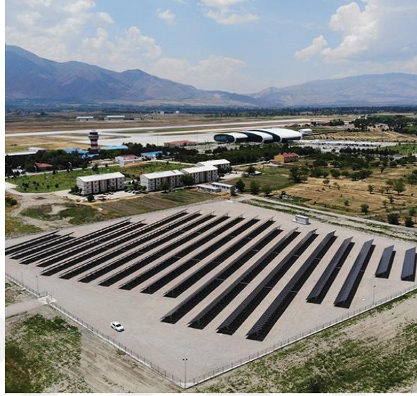
Şekil 2.4. Erzincan Havalimanı Güneş Enerjisi Santrali (http-4).
