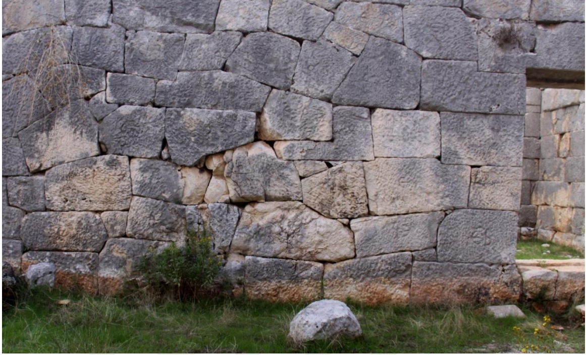
Resim 37. Horrea Hadriani G1 nolu oda 6a, Batı Duvar Poligonal Duvar Tekniđi, Myra ve Andriake Kazıları Arşivi, 2010.
