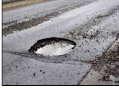
Şekil 19. Tuzun asfalta verdiği zarar
