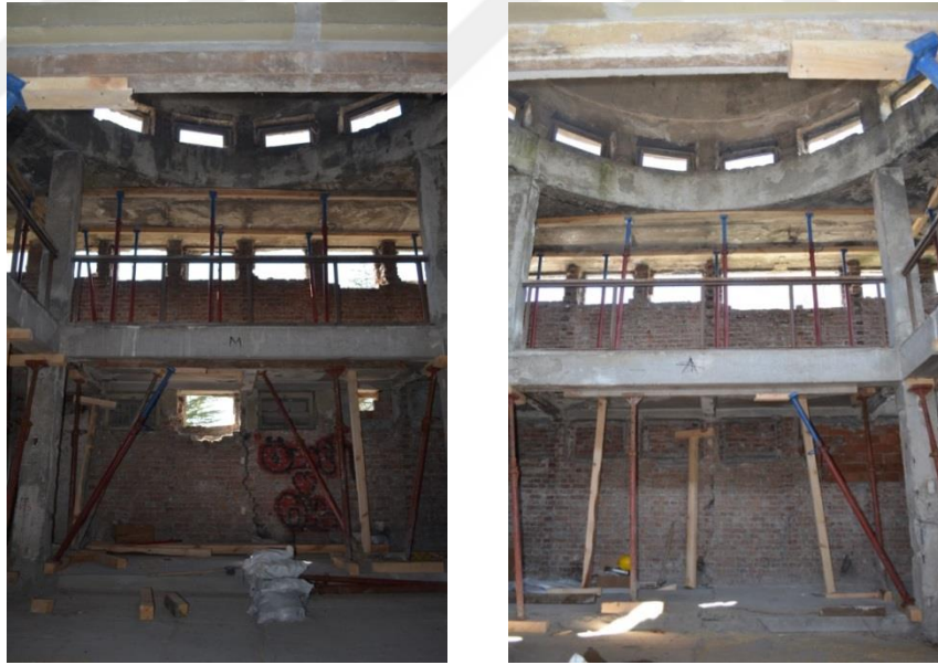
Görsel 174. ve 175. Yapıda Soğukluk Bölümündeki Doğu ve Batı Cephesinde Tuğla Örülerek Kapatılan Doğramalar (Kişisel arşiv, 2020).
