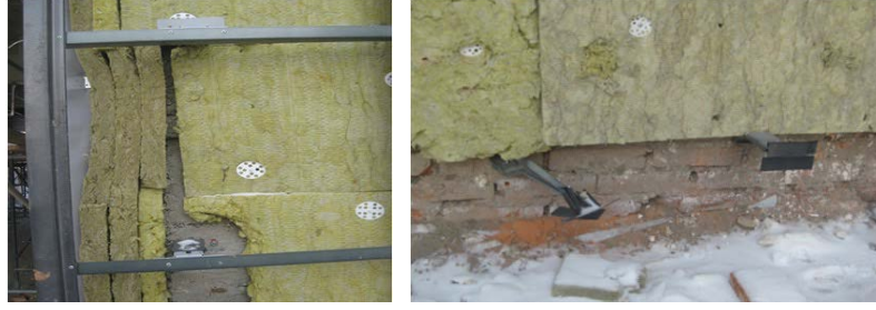
Şekil 1.4 : Cephe kaplama sistemi hasarı, örnek 4 (Endzhievskiy ve diğ, 2017).
