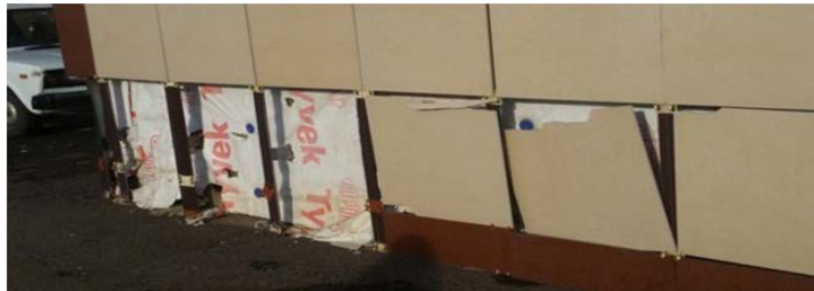
Şekil 1.3 : Cephe kaplama sistemi hasarı, örnek 3 (Endzhievskiy ve diğ, 2017).
