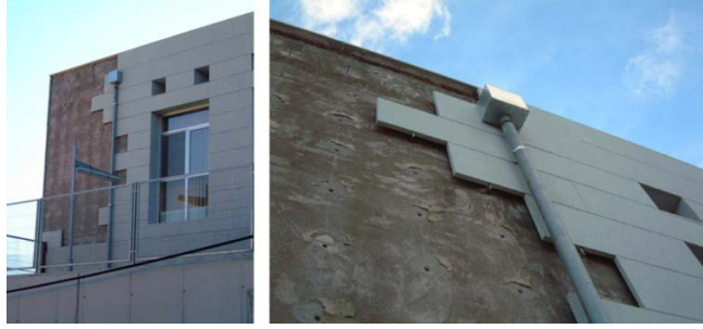
Şekil 1.1 : Cephe kaplama sistemi hasarı, örnek 1 (Ivorra ve diğ, 2013).
