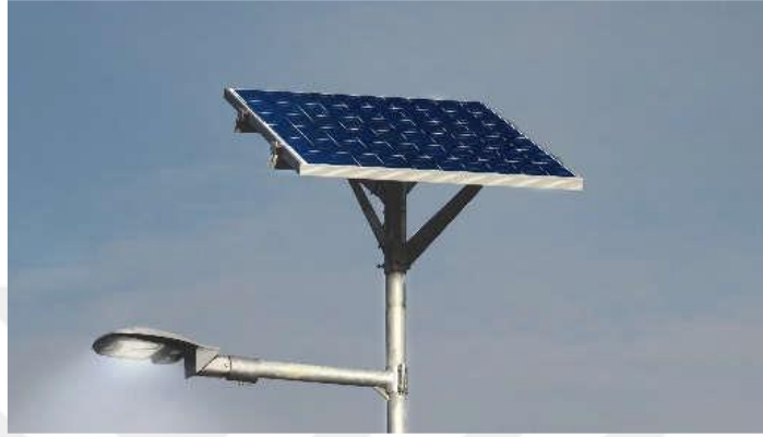
Şekil 2.1 Güneş enerji sistemlerinin sokak aydınlatmalarında kullanılması [13].
