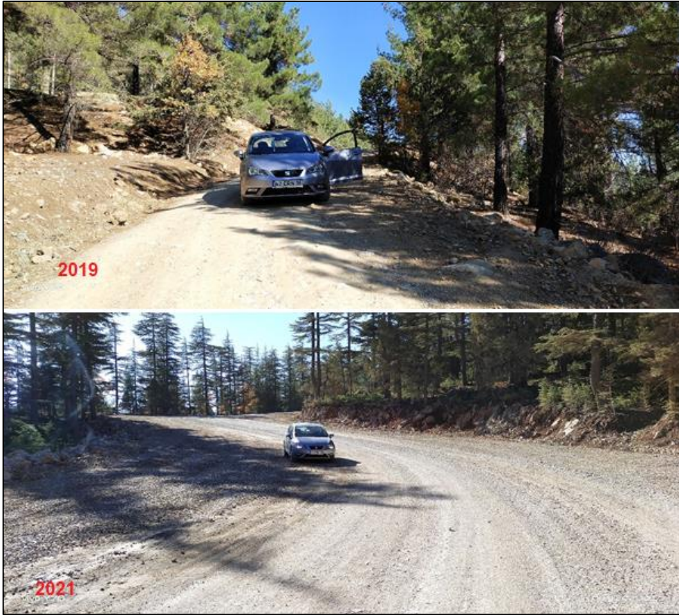
Fotoğraf 5.3. Alanda yol yapımı sonucu oluşan tahribat
