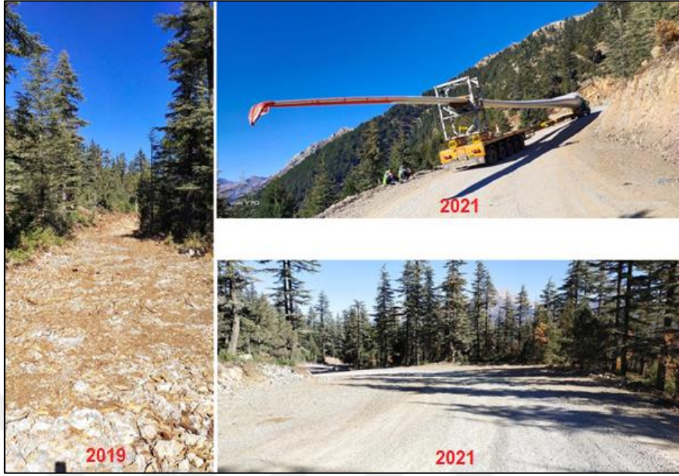
Fotoğraf 5.2. Alanda RES yapımı çalışmaları sonucu oluşan tahribat
