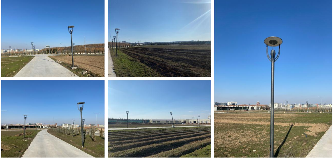
Şekil 4.16 TMBB Üretim Merkezi ve Üretim Seralarının olduğu bölgede kullanılan güneş enerjili aydınlatma elemanları (Orijinal 2022)
