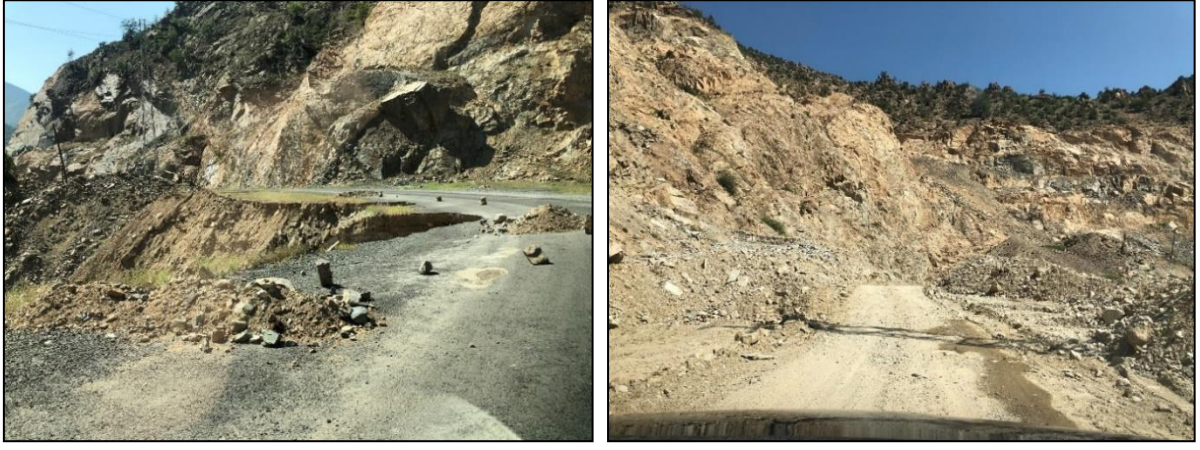
Şekil 21. Heyelan nedeniyle tahribata uğramış yol.
