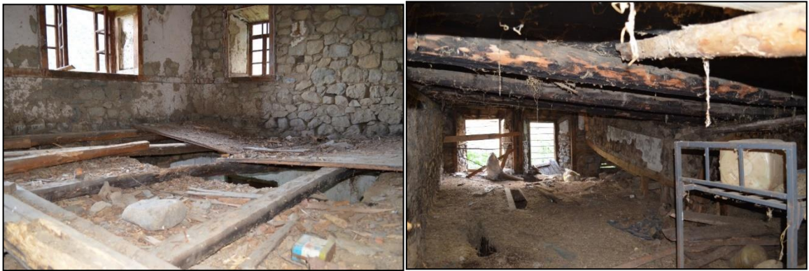
Şekil 46. Yıkılmak üzere olan yapılar.
