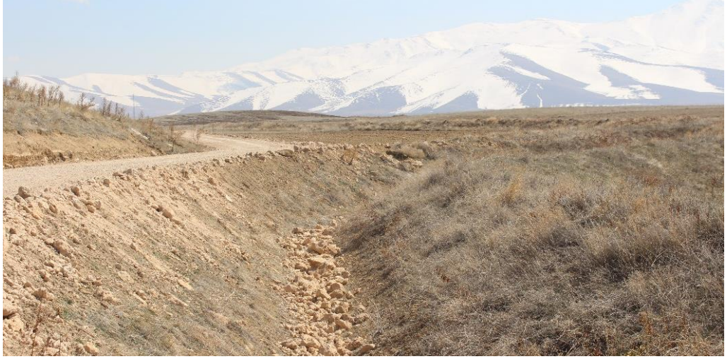
Resim 44: Yol alışmaları sırasında gerekleşen tahribat
