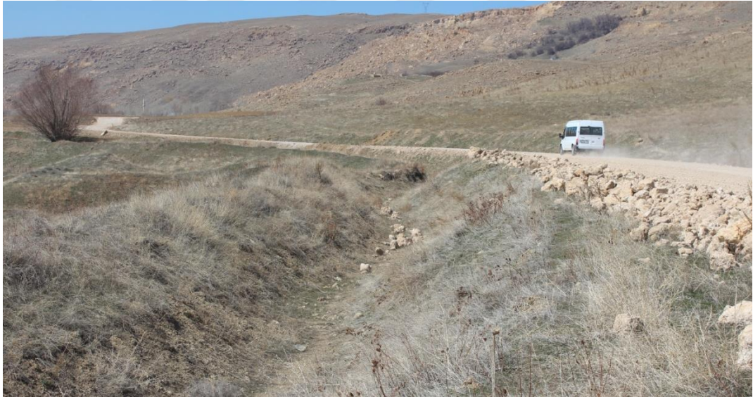
Resim 50: Tarihi kanalın beden duvarına zarar veren yol inşaatı
