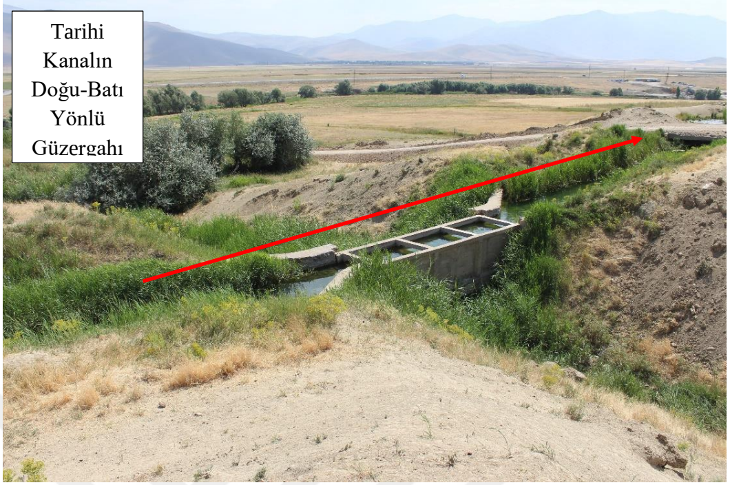
Resim 46: Kanalın yıkılan beden duvarı içerisine yerleştirilmiş beton yapı
