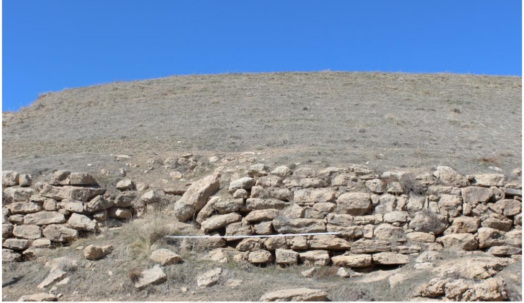
Resim 40: Toprak kayması sonucu istinat duvarlarında meydana gelen tahribat
