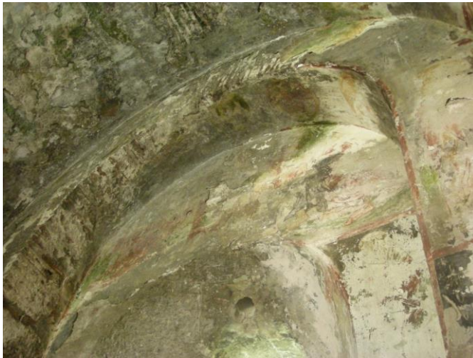
Resim 4.2. Duvar resmi yüzeyinde yosun ve bakteri oluşumu (Günözü,2015:106)
