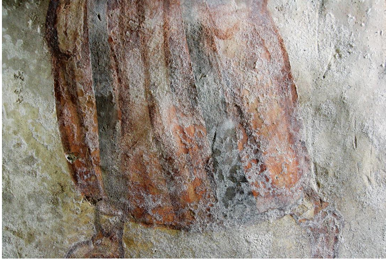
Resim 4.1. Çözünür tuzları oluşturduğu tuz çiçeklenmeleri (Weyer vd., 2015:166)
