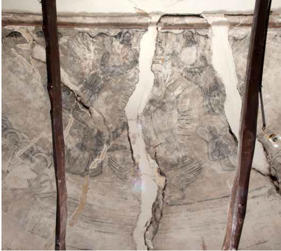
Resim 4.6. Hatalı onarım uygulaması (Valle vd., 2015:101)
