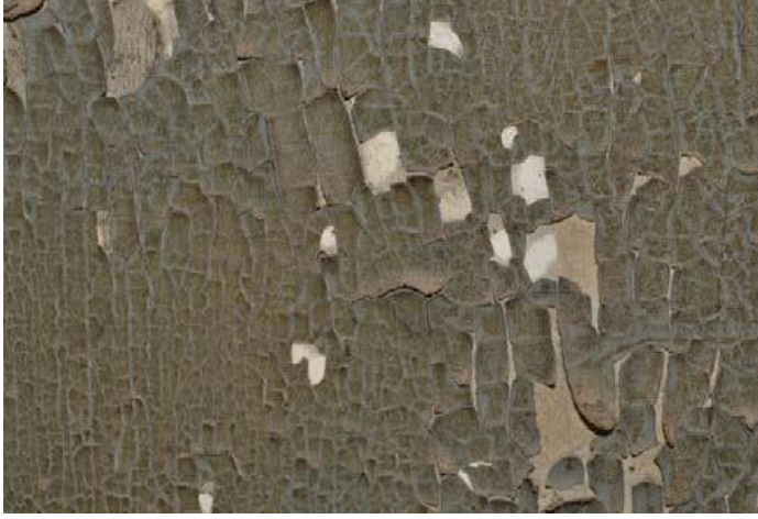
Resim 4.14. Duvar resminin kabarakarak dökülmesi (Abd. El-Tawab, Mahran, & Gad,2014:331)
