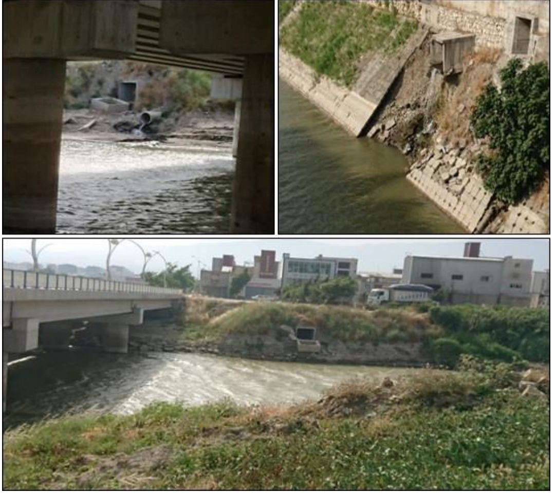
Şekil 4.1. Asi Nehri üzerinde bazı bölgelerde gözlemlenen kanalizasyon çıkışları.
