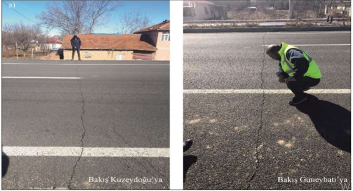
Şekil 4.25. Elazığ-Sivrice yolu ile Sivrice İlçesine kuzey batıdan girince, asfalt yolunu kesen K30 0 D doğrultuda çok ince kırık-çatlaklar gözlenmektedir (Kürçer ve diğ., 2020).
