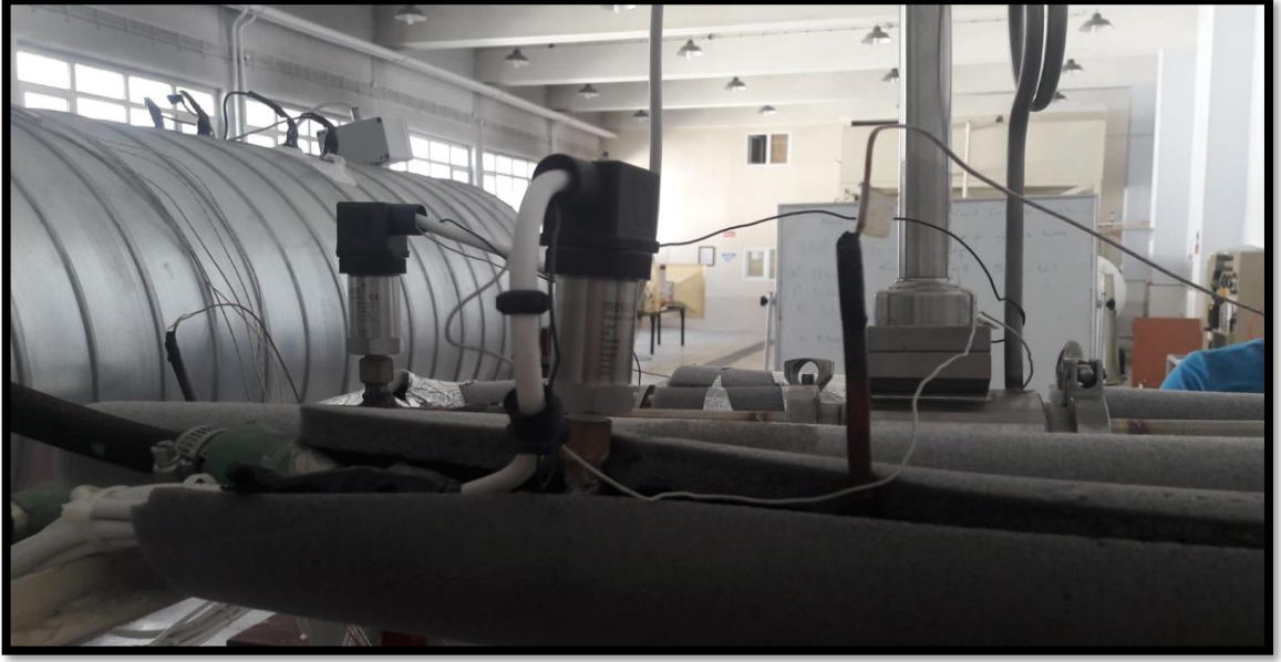
Şekil 24. Sistem basınç transmitter ve thermocouple bağlantısı
