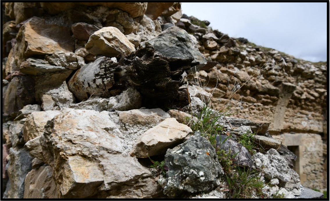
Foto 112. Kındık Tekkesi Duvar içerisinde kalan ahşap hatıl
