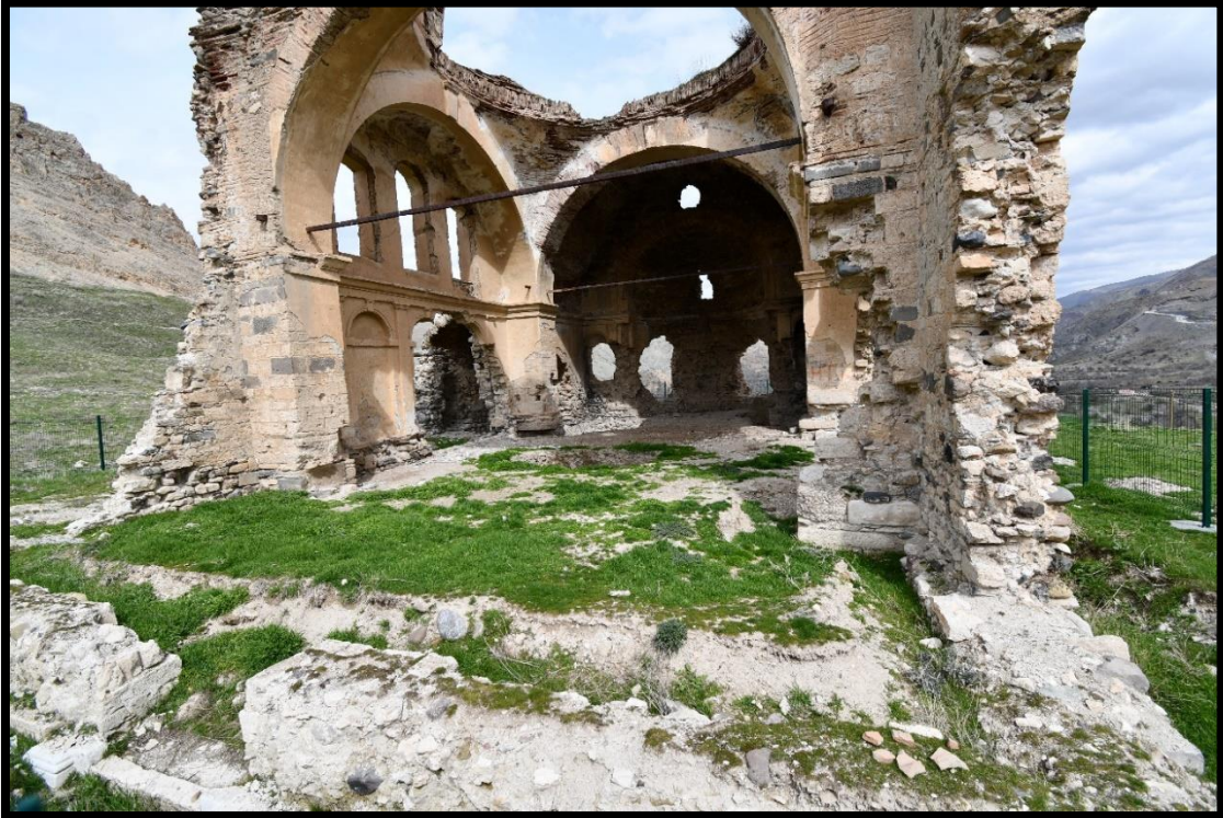
Foto 164. Surp Lusavoriç Kilisesi yıkık olan batı cepheye ait duvar izleri
