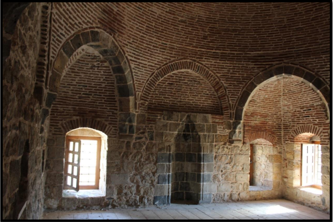
Foto 128. Alacalı Tekke Tevhidhane Güney Duvarı
