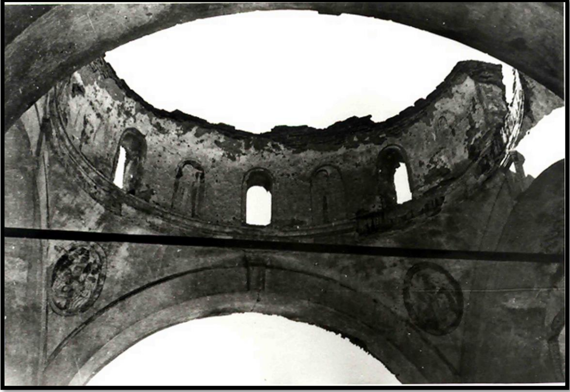
Foto 173. Surp Lusavoriç Kilisesi kubbe kasnağı ve geçişlerdeki süsleme izleri
