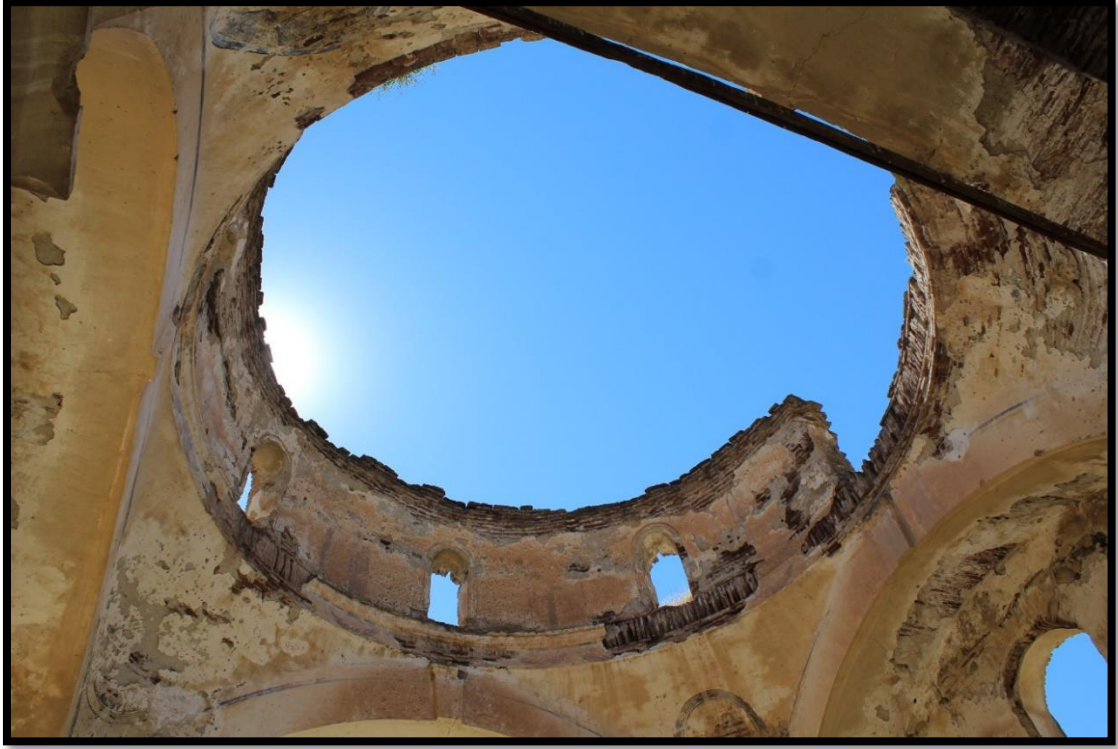
Foto 169. Surp Lusavoriç Kilisesi kubbe kasnağı ve geçişlerdeki süsleme izleri
