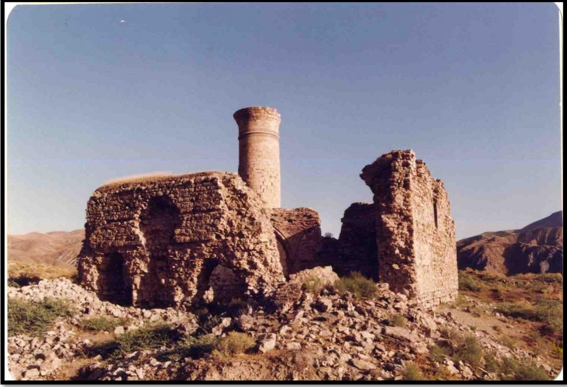
Foto 33. Küçük Cami kuzey duvarı tamamen yıkılmadan öncesi
