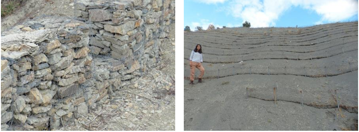
Şekil 4.25: Kutu gabion eşik (solda), kafes tel çit teras (sağda).
