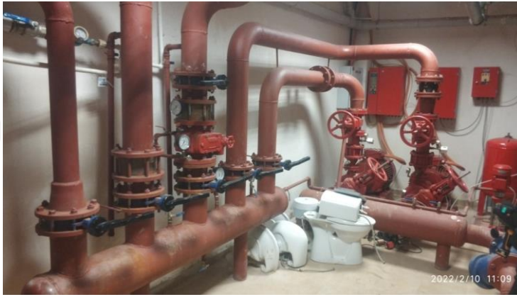
Görsel 5.38: Yangın Hidrantı
