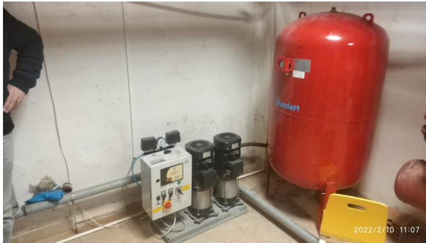
Görsel 5.40: Kullanma Suyu Hidroforu Pompa Etiketi
