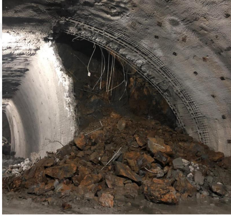
Şekil 4.66 : Bekleme makasında meydana gelen sökülme.
