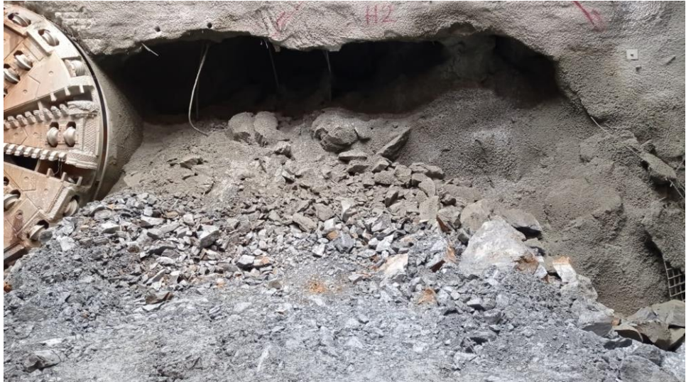
Şekil 4.65 : T14 servis istasyonunda meydana gelen sökülme
