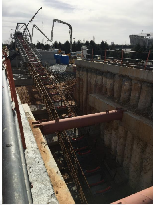
Şekil 4.43 : Konveyör bant sistemi.
