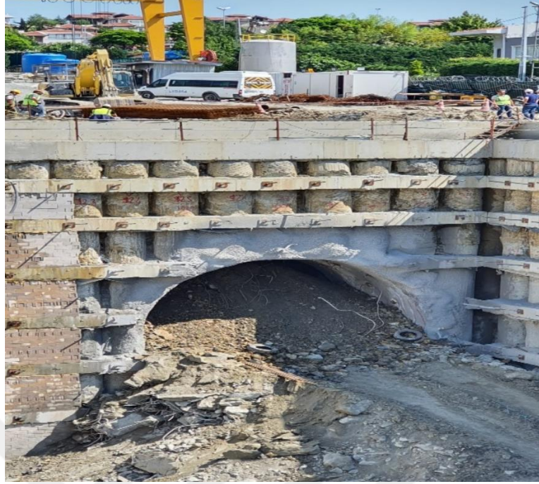
Şekil 4.64 : Arnavutköy 1 istasyonunda meydana gelen göçme
