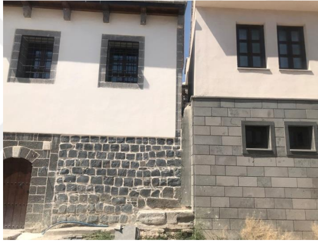
Şekil 59 Yapı Malzeme Farklılığı
