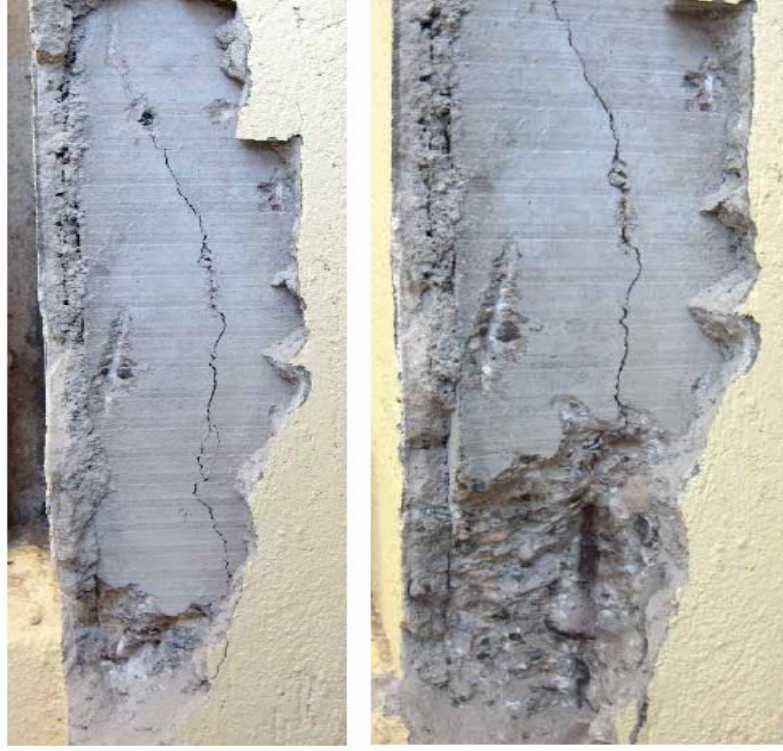
Şekil 2.24. Korozyona uğrayan çelik sonrası betonda oluşan çatlak-kırılma [46].
