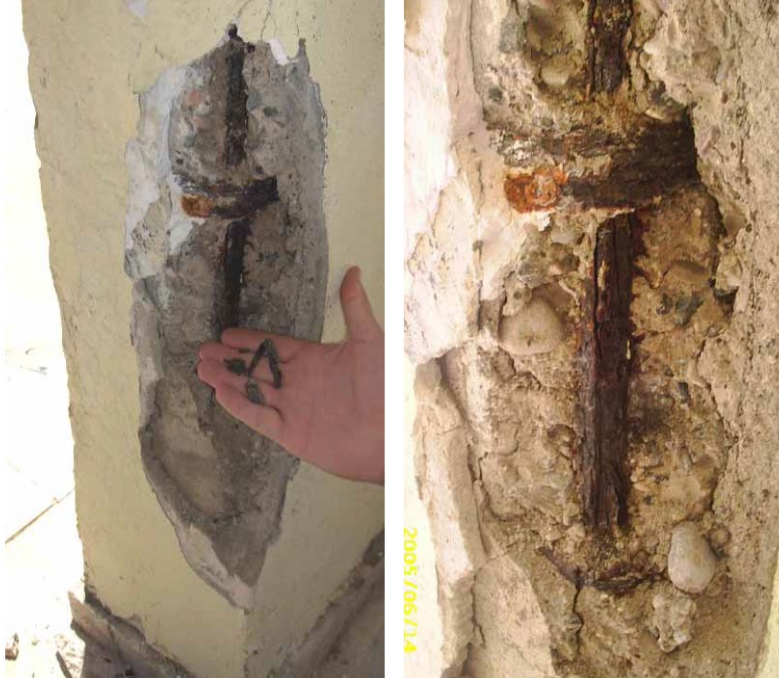
Şekil 2.25. Uzun süre korozyona uğrayan çeliğin ufalanması [46].
