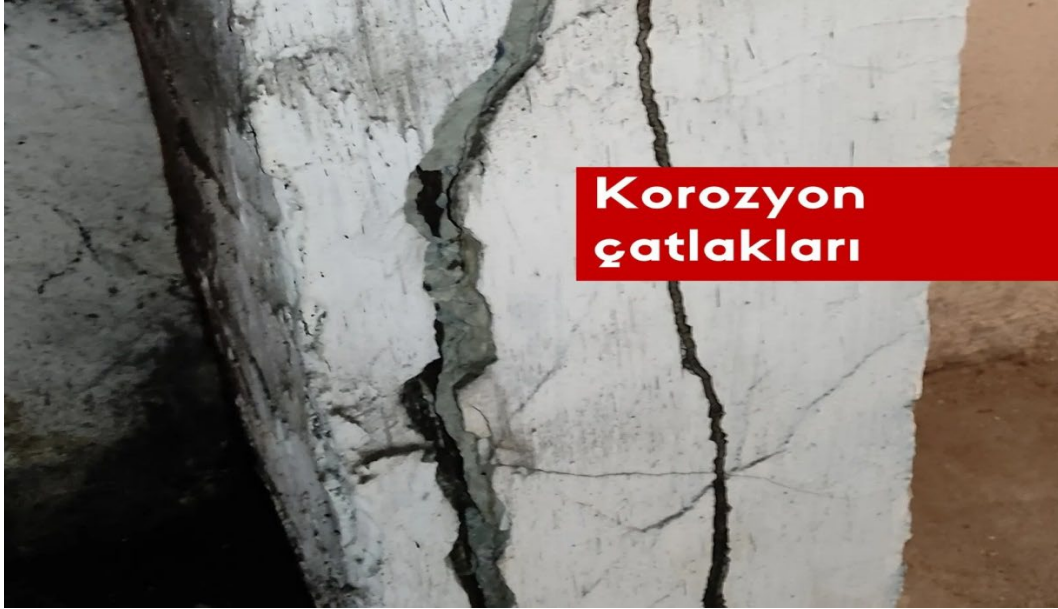
Şekil 2.5. Betonda korozyon çatlakları [27].
