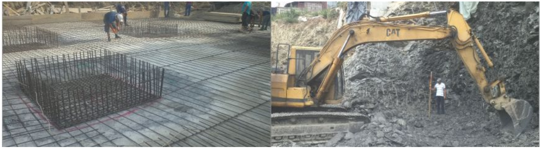
Şekil 2.16 : Toprak işleri, beton güçlendirme ve bina yapım sürecinin diğer birçok kısmı da binanın genel güvenliğini etkileyebilir.
