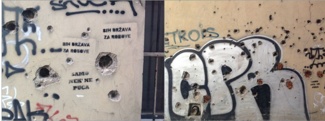
Şekil 1.3 : Saraybosna'daki binaların duvarlarında kurşun izleri.
