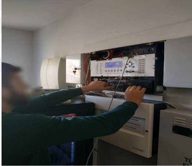
Şekil 26: Yıllık Bakımı Yapılan Yangın Söndürme ve Duman Dedektörleri
