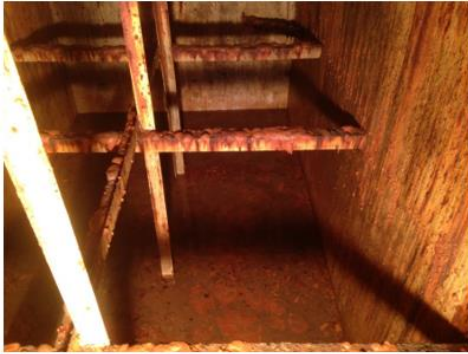
Resim 2.5. Temizliği yapılmamış bir bina içi su deposu
