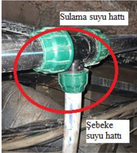
Resim 4.39. Çapraz bağlantı yapılan sulama ve şebeke suyu hattı
