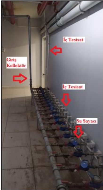
Resim 3.1. Bina içi su dağıtım yapısı
