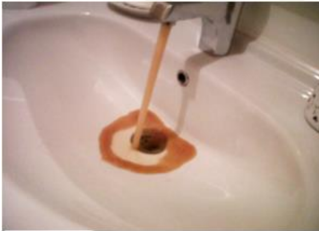
Resim 2.8. Bakımı yapılmamış sıhhi tesisat nedeniyle musluktan akan suyun görüntüsü
