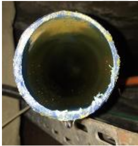
Resim 4.8. (6. nokta) Numune alınan boru yüzeyi
