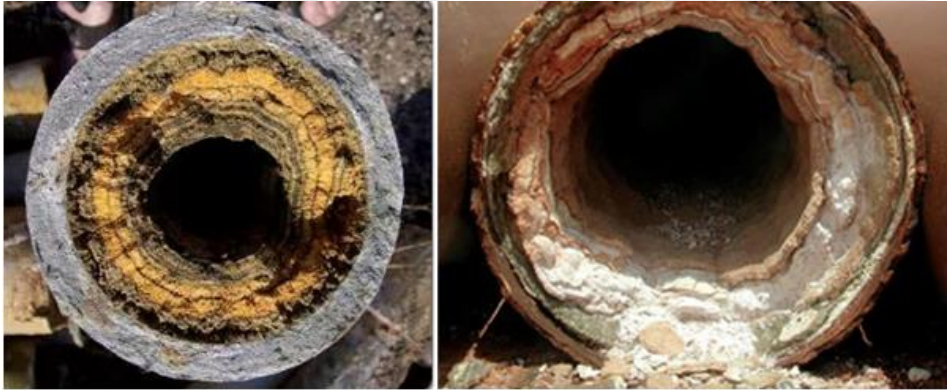
Resim 2.4. Kalsiyum karbonat çökeltisi oluşmuş termal borular
