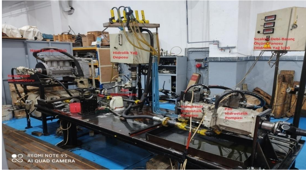
Şekil 4.2.Dizel Hidrolik Lokomotif Hidrolik Ekipmanları Test Düzenegi
