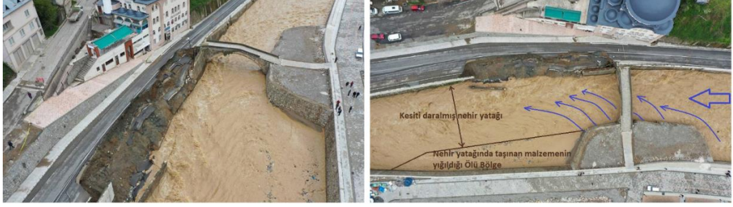
Şekil 21. 2022 yılında meydana gelen taşkın sonrası yolda oluşan çökmeler (URL-11)
