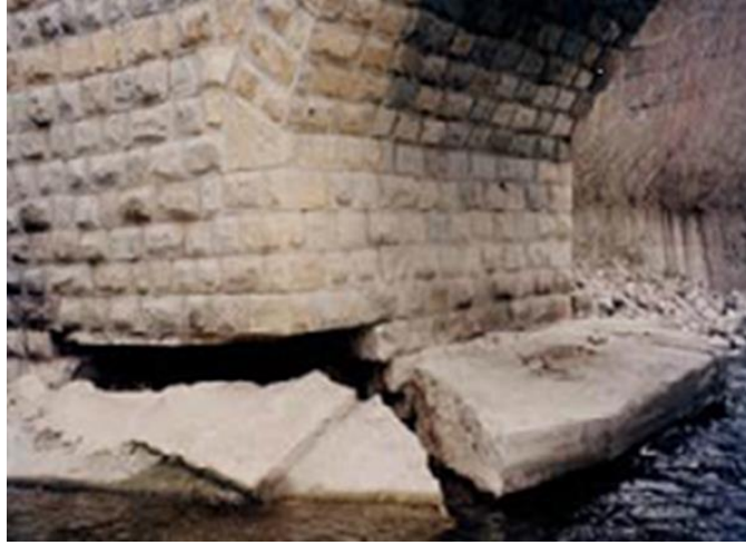
Şekil 6.3. Trabzon Matarcı Köprüsünde zemin kaynaklı oluşan hasar
